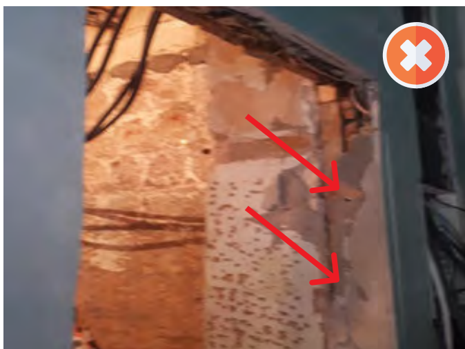
Проем с наплывами раствора и проводами
