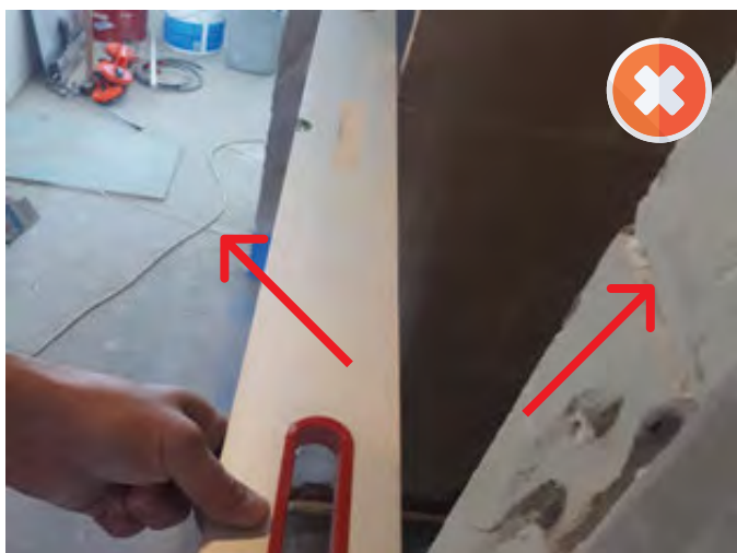
Проем не прямоугольной формы с наплывом раствора
